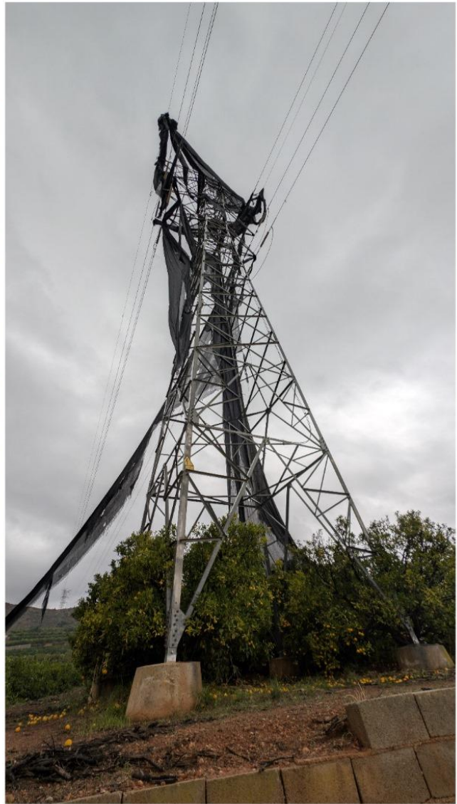
Siguió hacia el oeste, más daños Fuente: Inforatge
